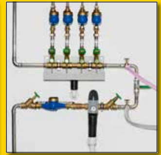
Desinfektion von Trinkwasserinstallationen (S/SL/SLW)
