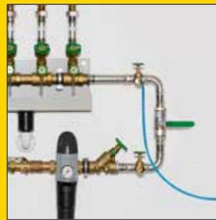
Druckprüfung mit Druckluft (SL/SLW)
